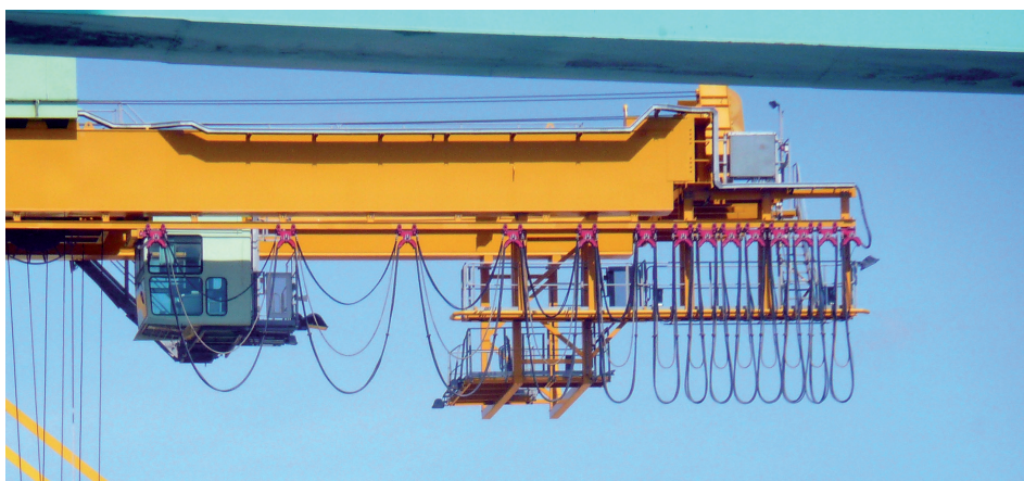
Figura 66. Sistema festoon de una grúa de muelle
