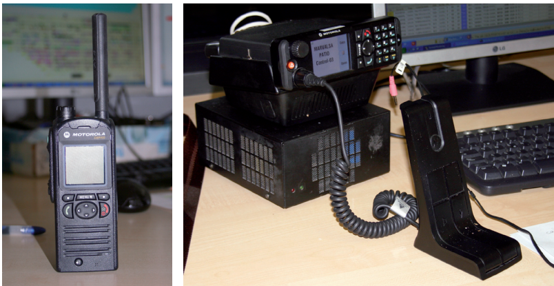
Figura 47. Equipos de radio portátiles y móviles
